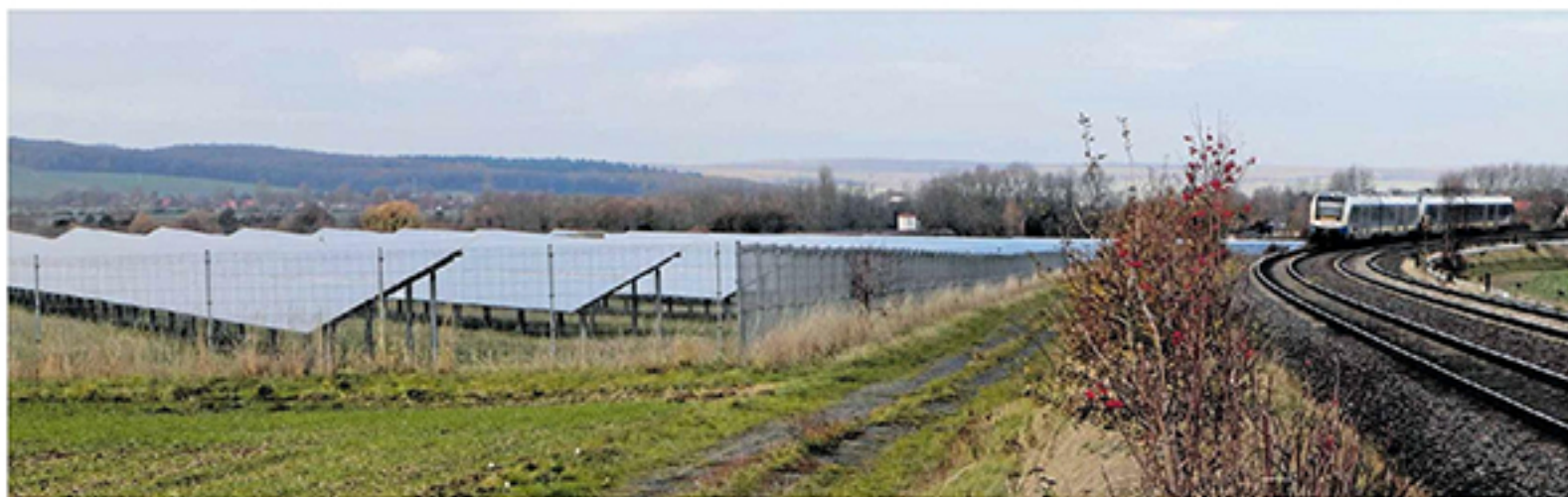
Ebenfalls direkt neben den Bahngleisen der Strecke Goslar-Ringelheim befindet sich die erste große Photovoltaikanlage-Freiflächenanlage der Gemeinde. Bei Dörnten soll 2023 eine weitere entstehen.
